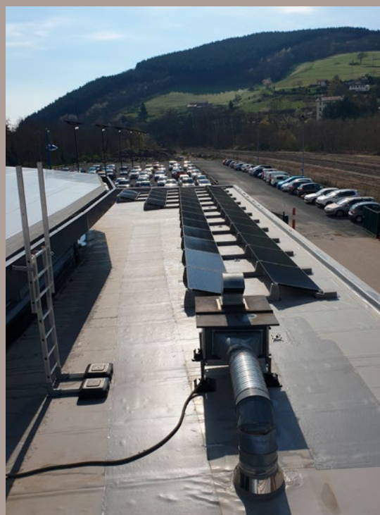
Vue d'un toit solaire
