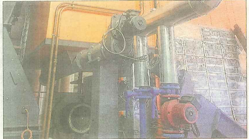
Tout est parti de l'installation d'un réseau de chaleur en 2006 et de cette chaufferie bois qui alimente bâtiments communaux et même certains particuliers. Photo JSL/Meriem SOUSSI
